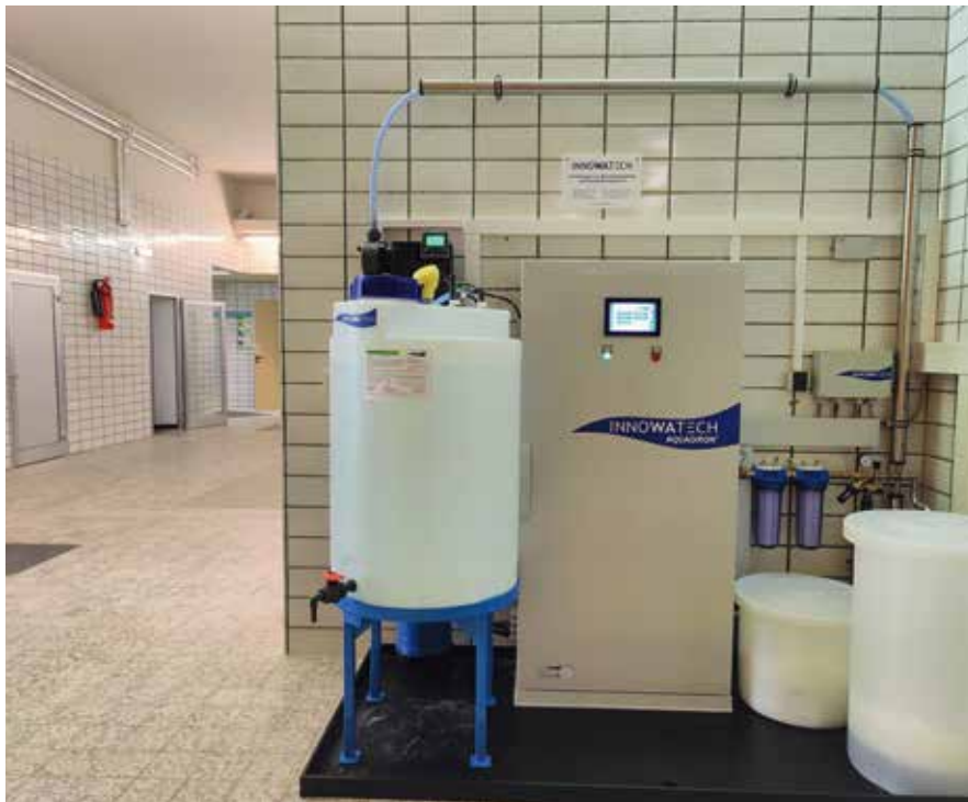
INNOWATECH Aquadron® ECO im Wasserwerk.
