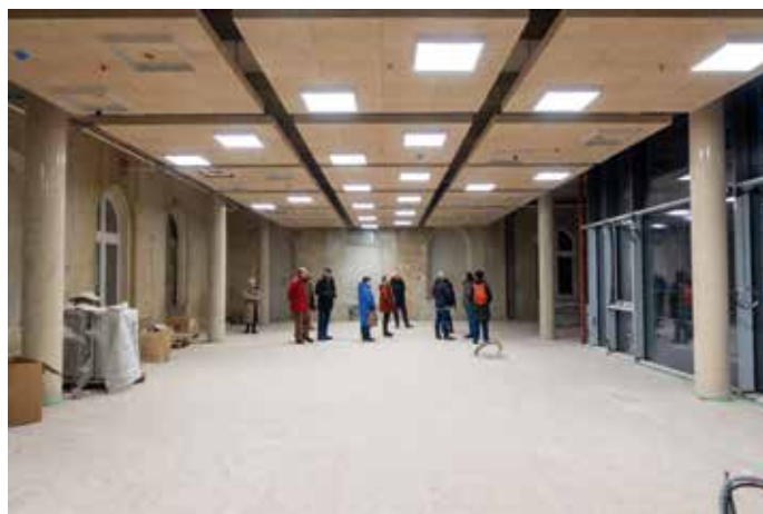
Holzwolleplatten an der Decke zur verbesserten Wärmedämmung und Akustik.
